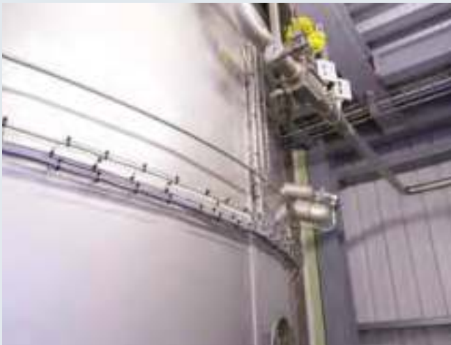
En tinas y silos
